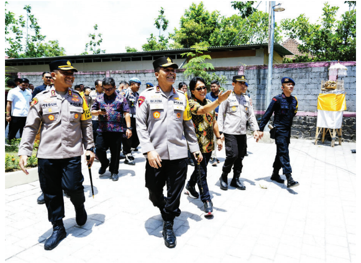
Bupati Giri Prasta (tiga kiri) bersama Kapolres Badung AKBP Teguh Priyo Wasono (kiri) sesuai mendampingi Kapolda Bali Irjen. Pol. Ida Bagus Kade Putra Narendra (dua kiri) meninjau pembangunan asrama dan poliklinik Polres Badung, Selasa (16/01) ANTARA/HO-Humas Pemkab Badung
