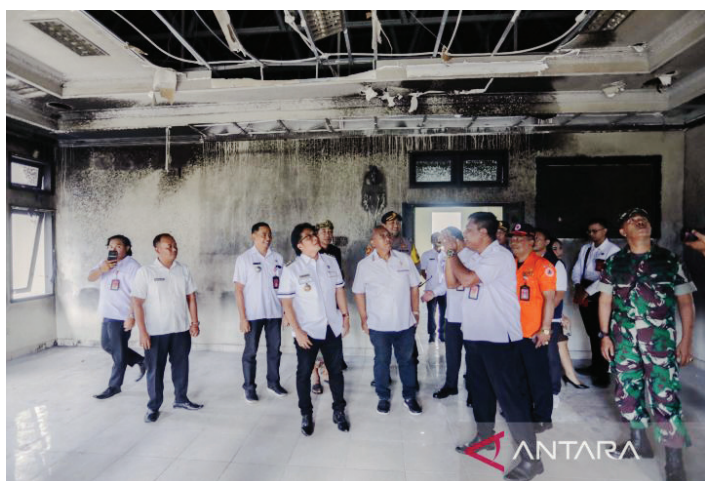
Bupati Badung I Nyoman Giri Prasta meninjau bangunan yang terdampak kebakaran. ANTARA/HO-Pemkab Badung
